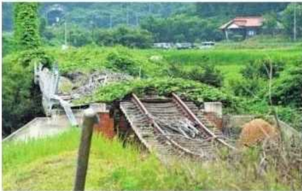
全線運休が続くJR美祢線の線路
