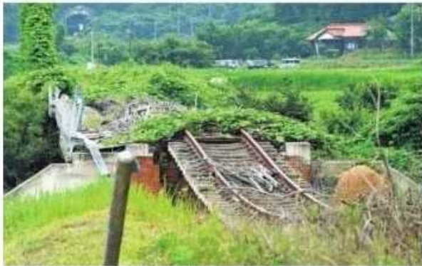
全線運休が続くJR美祢線の線路
